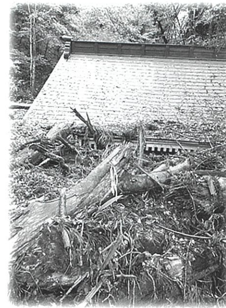
神社に土砂が崩れた災害現場
